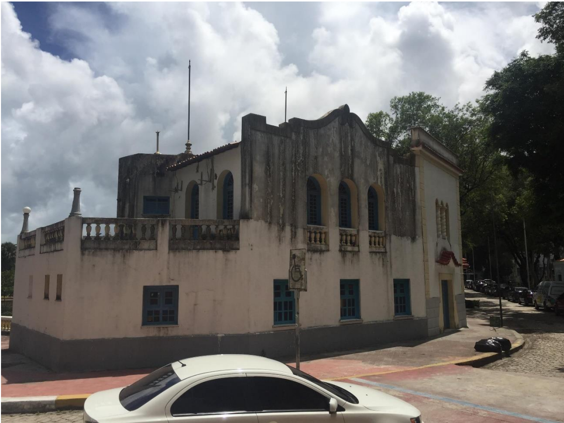
O Casarão encontrava-se em alto grau de deterioração de seus elementos como esquadrias, vitrais e balaustradas, além de danos estruturais e de coberta.
