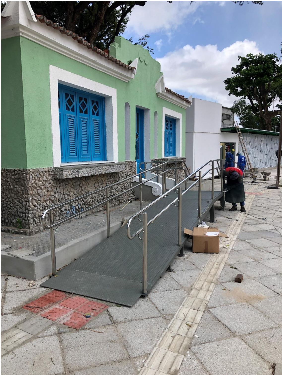
Rampas de acesso às edificações foram projetadas em estrutura metálica utilizando do conceito de reversibilidade e diferenciação entre o elemento histórico e o contemporâneo
