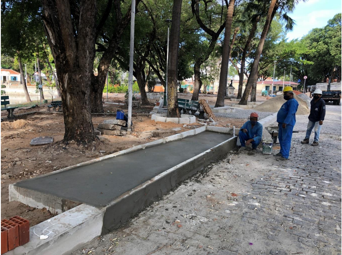
Execução de rampas de acesso ao desnível entre a rua interna e a calçada. Originalmente o projeto previu a elevação da via, mas a partir de problemas técnicos não pôde acontecer, por isso tiveram que ser locadas diversas rampas em todo o perímetro da via para garantir total acessibilidade no espaço público
